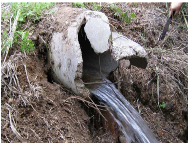
Déversement d'eau sur le site, en provenance du domaine des Hauts de Vaugrenier (le 24/11/09).
